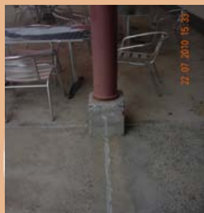
Etat d'un poteau avant
