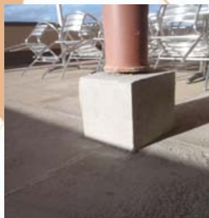
Etat final d'un poteau
