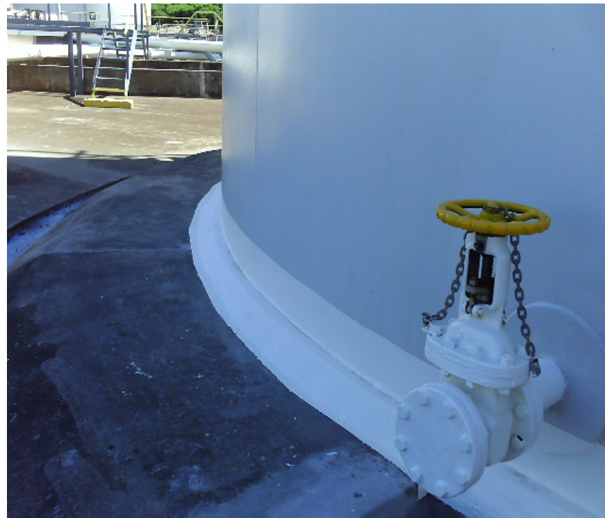
Vue d'ensemble pieds de cuve .
