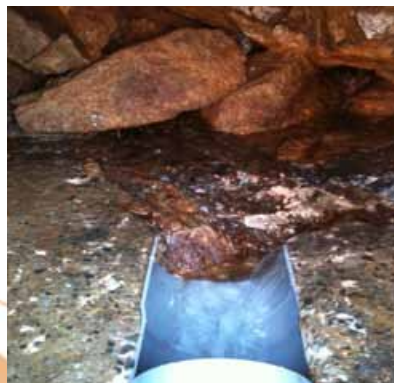
Absence de revêtement sur béton
