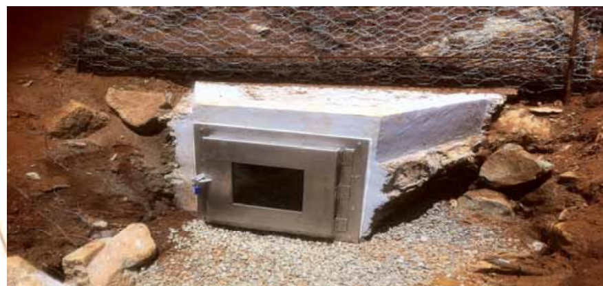
Porte inox alimentaire pour sécuriser l'accès mais permettre relevé d'échantillon
